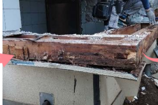
腐食した窓の土台
